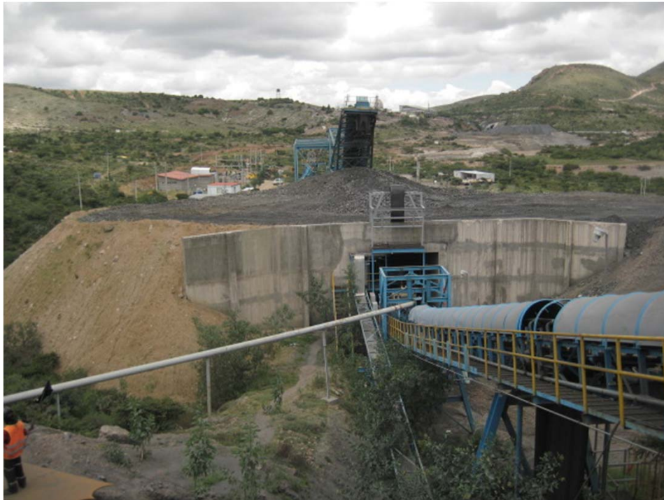
Detalle de la banda principal de la planta de beneficio Compañía Minera Real de Ángeles, S.A. de C.V. (Unidad Santa Francisca), Grupo Frisco, S.A. DE C.V., municipio de Asientos, Ags.
