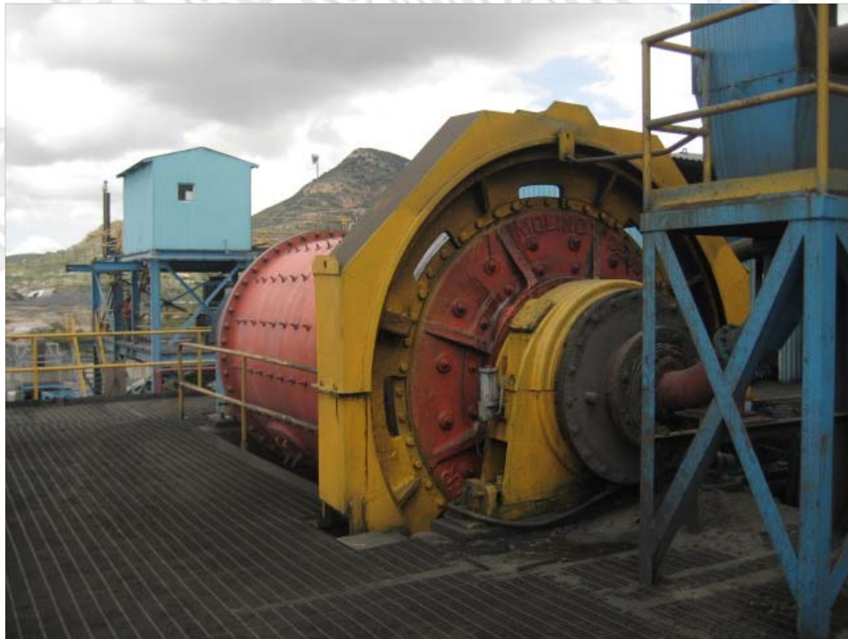
Molino "SAG-Semiautógeno " de la planta Santa Francisca
