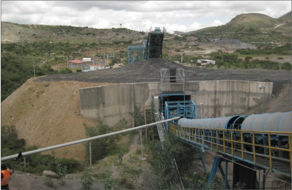
Detalle de la banda principal de la planta de beneficio Compañía Minera Real de Ángeles, S.A. de C.V. (Unidad Santa Francisca), Grupo Frisco, S.A. DE C.V., municipio de Asientos, Ags.
