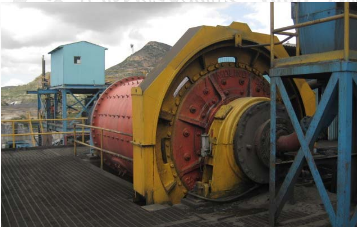
Molino "SAG-Semiautogeno " de la planta Santa Francisca
