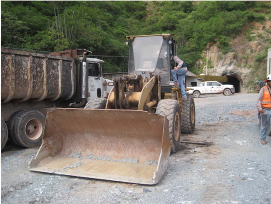
Equipo y bocamina del nivel 17, será el nivel principal de acarreo. Obra minera de sección 5 x 5 m
