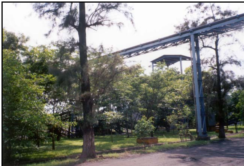
Banda transportadora dentro de la planta peletizadora de Estación Alzada, Mpio. de Cuauhtémoc, Col.
