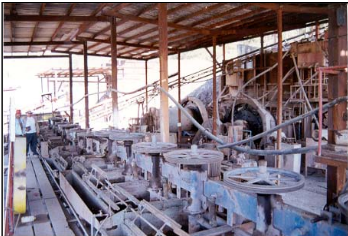
Planta de beneficio en mina La Sarda, desmantelándola para llevarla a Florida Mine, proyecto Santa Maria del Oro, municipio del mismo nombre Nay.
