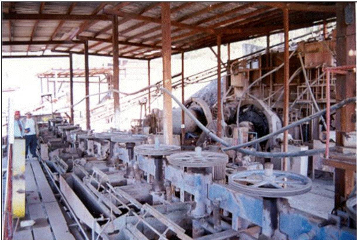
Planta de beneficio en mina La Sarda, desmantelándola para llevarla a Florida Mine, proyecto Mina Real, en Santa María del Oro, Nay.
