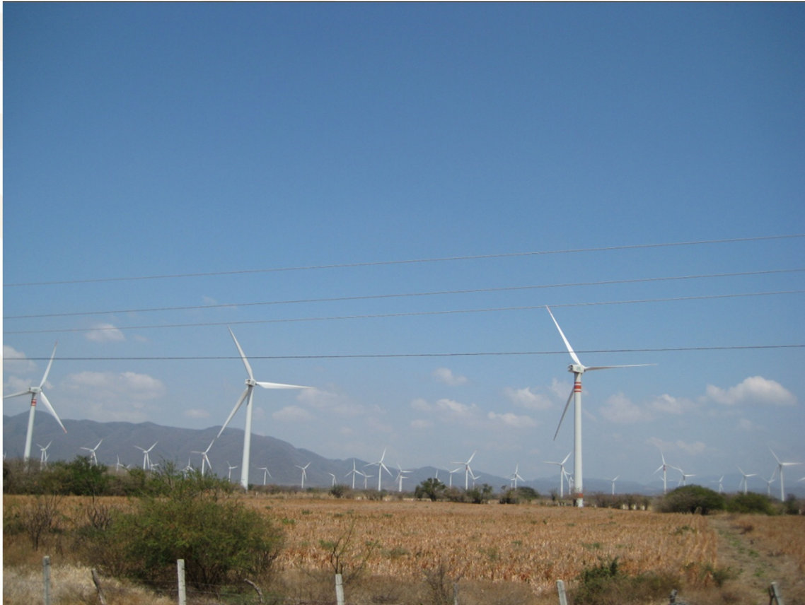
Parque eólico con aerogeneradores de energía eléctrica en el Istmo de Tehuantepec, Oax.
