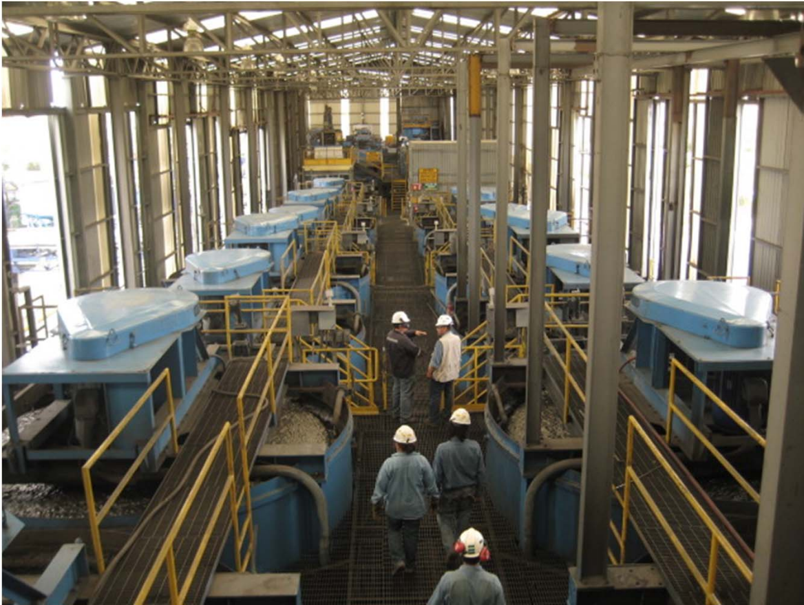
Área de flotación de la Planta de beneficio de Francisco I. Madero, Compañía minera Peñoles, S.A. de C.V.
