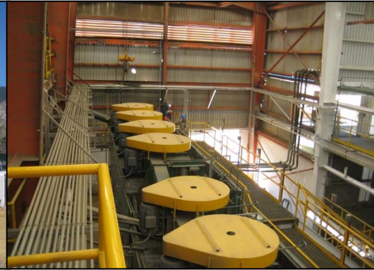
Celdas de Flotación
