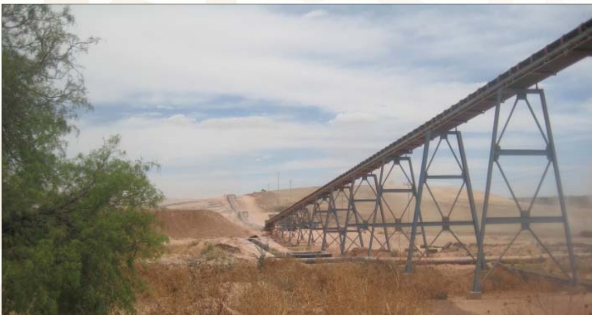
Bandas Transportadoras de material de mina del tajo a las camas de lixiviación.
